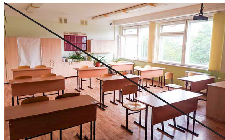
Плохо Линолеум под дерево
