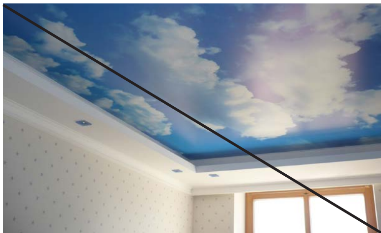
Плохо Натяжные потолки. Потолки с рисунками
